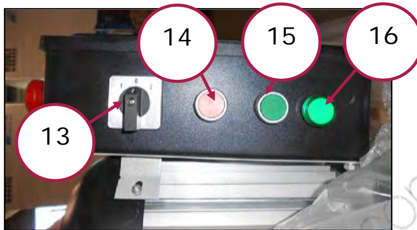
Figura 12 – Dettaglio interruttori motore.
