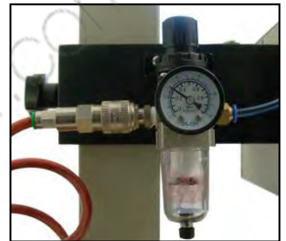
Figura 20 – Collegamento aria compressa.
