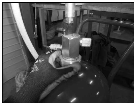
Figura 11 – Flangia collegamento tubazione.
