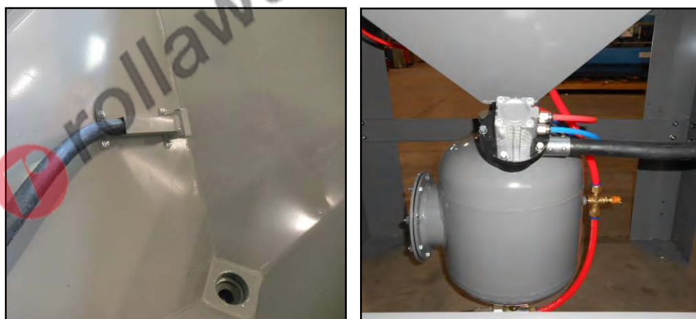
Figura 13 - collegamento tubo aria compressa da valvola del serbatoio a tubo rigido presente all'interno della tramoggia.
