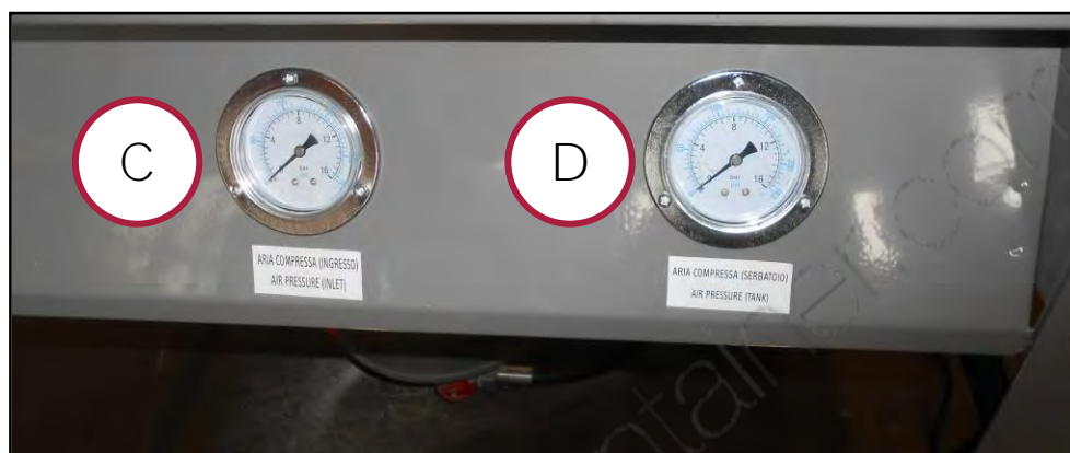
Figura 19 - manometri controllo pressione aria compressa.
