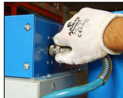
Figura 13 – Attacco dell'aria compressa.
