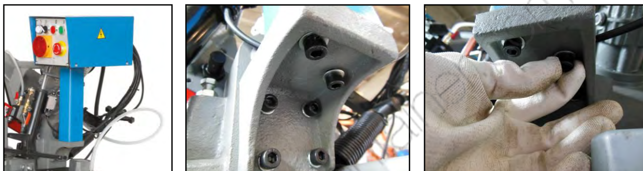
Figura 16 – Dettaglio fissaggio del quadro elettrico.
