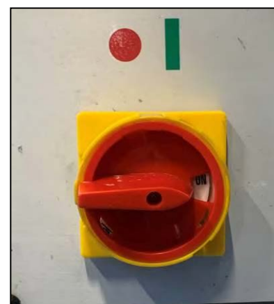
Figura 7 - Sezionatore generale dell'alimentazione elettrica.
