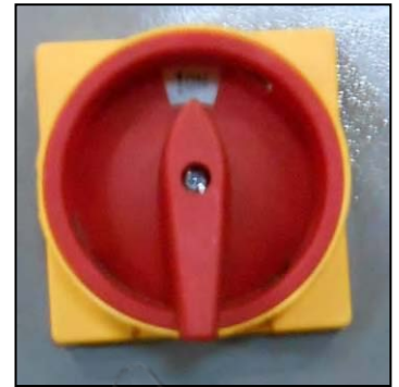
Figura 7 - Sezionatore generale dell'alimentazione elettrica.
