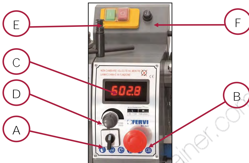
Figura 14 – Quadro di comando.
