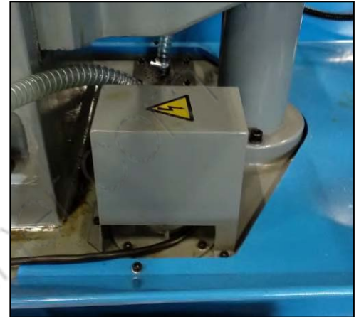
Figura 21 - Motore elettrico della pompa di refrigerazione.
