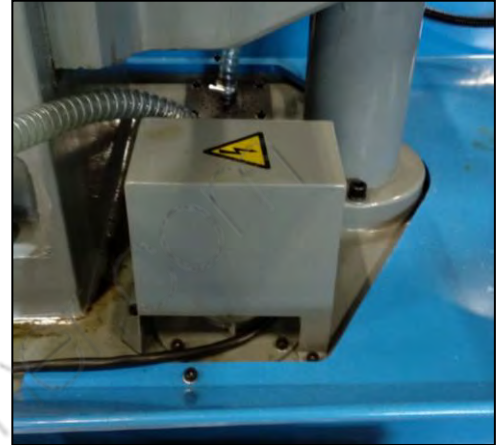
Figura 18 - Motore elettrico della pompa di refrigerazione.
