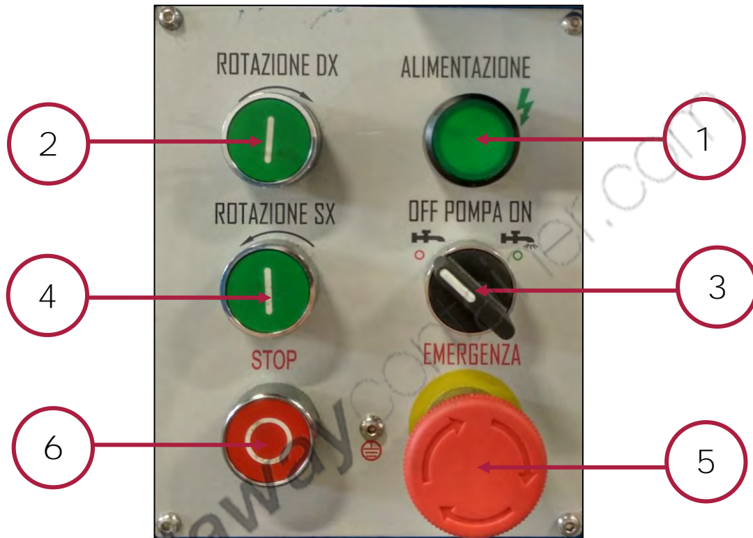
Figura 7 – Quadro di comando della macchina.
