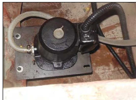
Figura 18 - Motore elettrico della pompa di refrigerazione.
