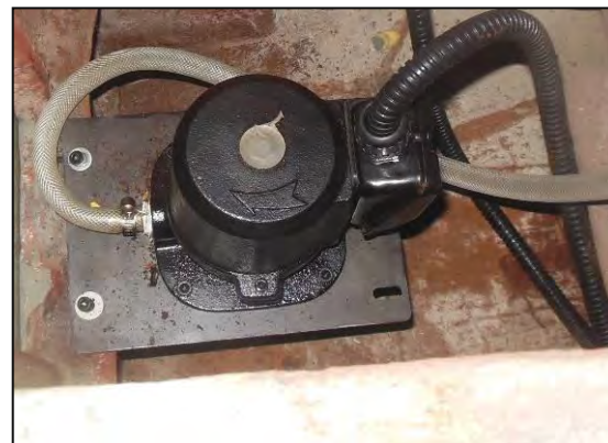
Figura 19 - Motore elettrico della pompa di refrigerazione.
