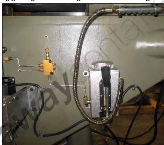
Figura 37 – Impianto di lubrificazione.
