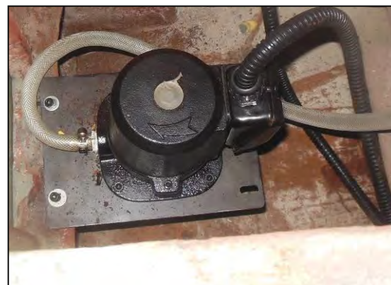
Figura 19 - Motore elettrico della pompa di refrigerazione.
