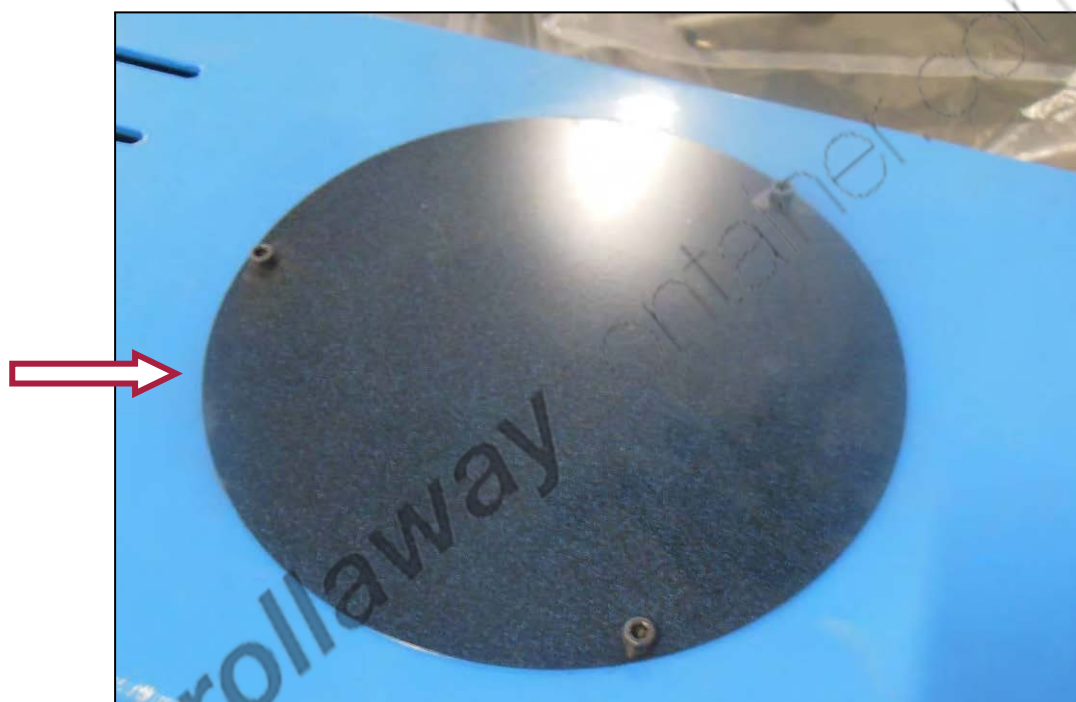
Figura 18 Riparo fisso sul carter pulegge.
