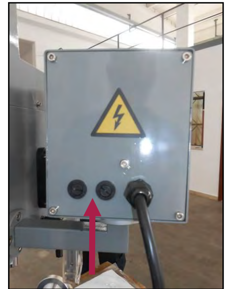
Figura 18 - Alloggiamenti fusibili di sicurezza.
